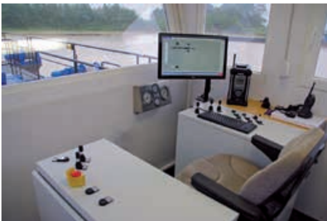
DIE STEUERKABINE enthält den Steuerstand und einen Teil der Automatisierungstechnik. Fotos und Grafiken: Team
